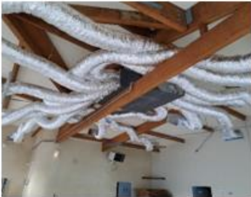
Nouveau Système de chauffage par pompe à chaleur
